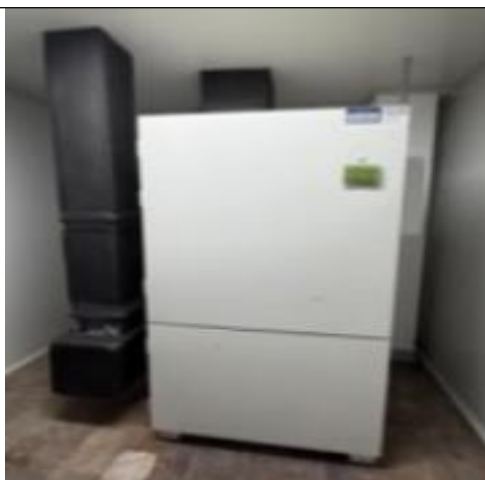
粉碎工序滤筒除尘器
