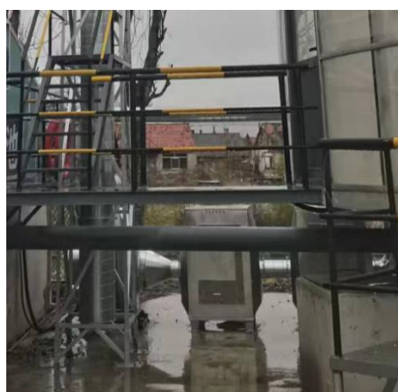
污水处理站除臭装置
