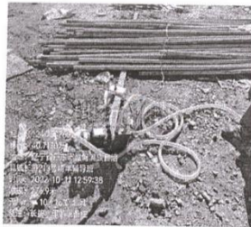
2#地下水采洗井
